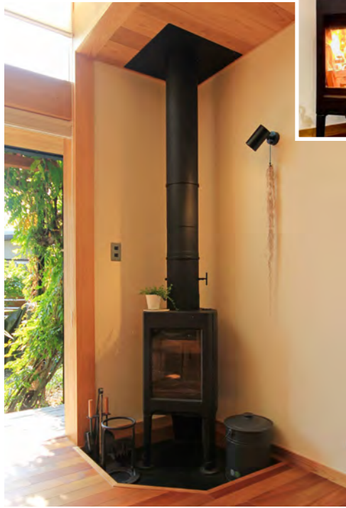
薪ストーブ ダイニングのコーナーに配置した縦長の薪ストーブは、ヨツールのF162ブラックペイント。コンパクトだがガラス面が大きく、炎が綺麗に見える。
