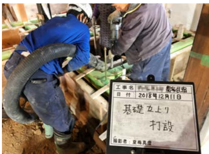
土台の脇からコンクリートを打設する。狭い場所なので難しいが、奥まで充填するようにパイプを使ってしっかりとコンクリートを送る事。
