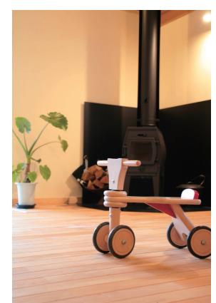
薪ストーブは、SCAN の CI-1GCB。小型だが、暖房能力の大きいストーブ。(残念ながら昨年で廃盤になってしまった)
